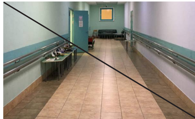
Плохо Керамогранитная плитка с крупными швами
